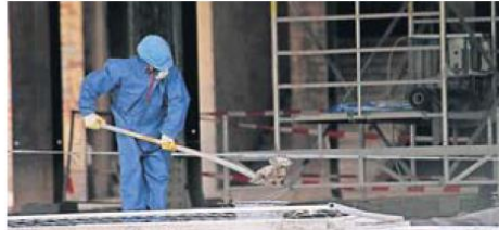
Gefährliche Arbeiten – wie hier mit Asbest-Schutt – können zur Gefahr für Leben und Gesundheit werden. FOTO: PRIVAT
