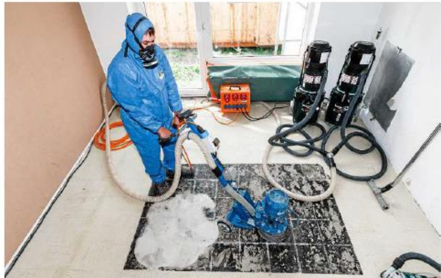
Bei der Sanierung von Altbauten ist die Asbest-Gefahr im Kreis Wesel groß: Davor warnt die Gewerkschaft IG Bau.
